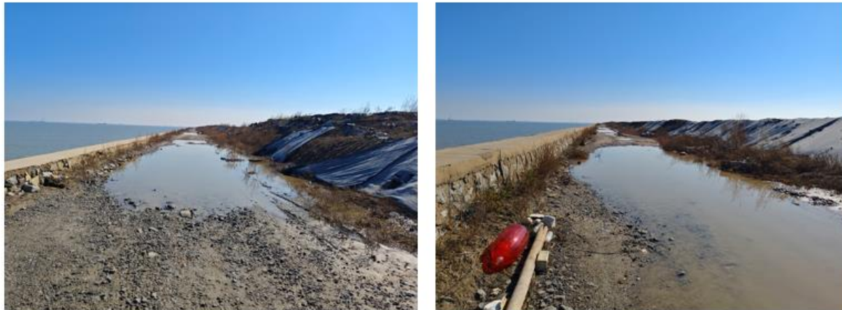
道路积水照片
